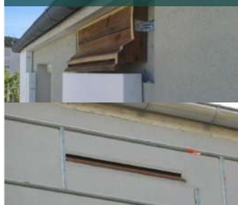
Gîte à chiroptères intégré dans l'ITE. © L. Arthur
